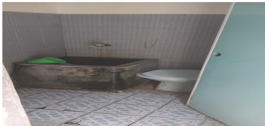
Gambar 3 . Toilet Kotor dan tidak dirawat Sumber : Dokumentasi Pribadi Februari 2021
