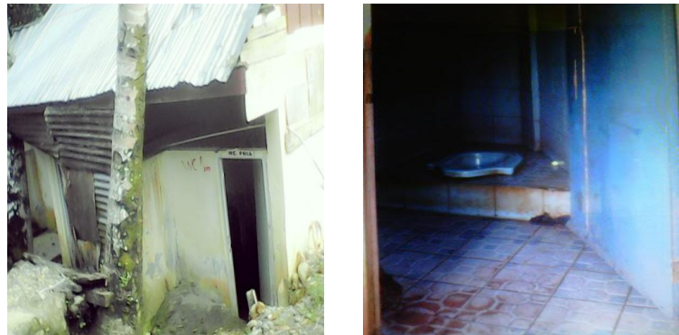
Gambar 1. Kondisi Toilet dan Ruang Ganti tidak Terawat (Dokumentasi April 2015)
