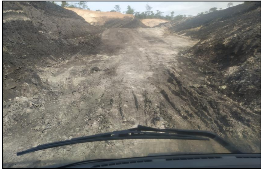
Gambar 12. Kondisi Hauling Road Yang Bergelombang dan sempit
