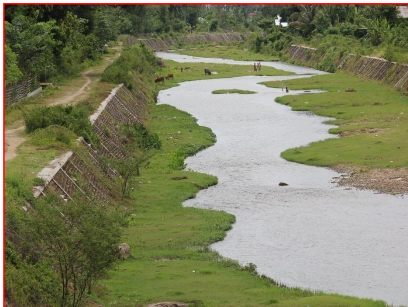
Gambar 2. Penyempitan alur Sungai Batang Painan Akibat Sedimentasi Sumber: Dokumentasi, 2016
