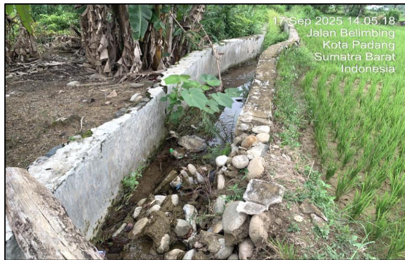
Gambar 1. Keruntuhan Dinding Saluran Sumber : Dokumentasi Pribadi
