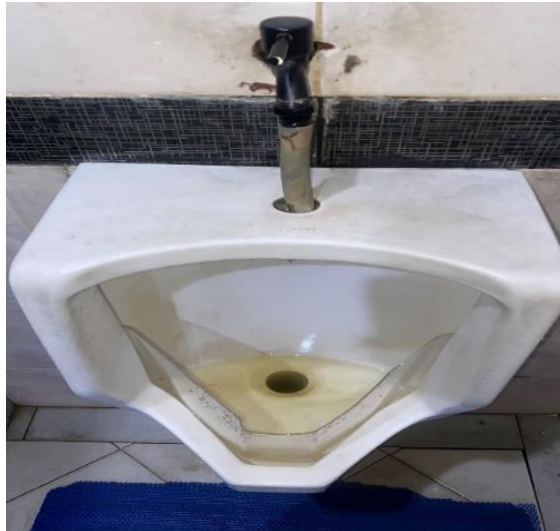
Gambar 1. Kondisi Urinal Ketika Mampet Sumber: Dokumentasi Pribadi, 2025
