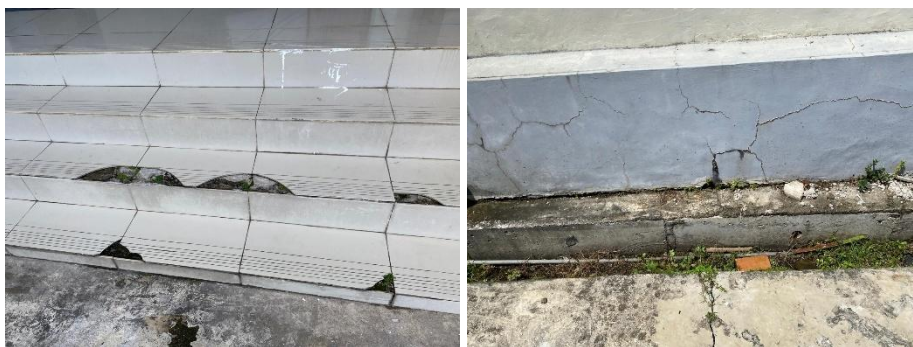
Gambar 1. Retakan pada Keramik dan Dinding Sumber : Dokumentasi Pribadi, 22 Juli 2025.
