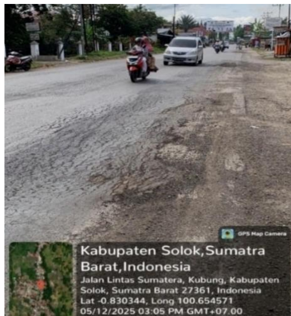
Gambar 2. Kondisi Jalan Pada ruas Jalan Raya Koto Baru Sumber: Hasil Observasi 12 Mei 2025
