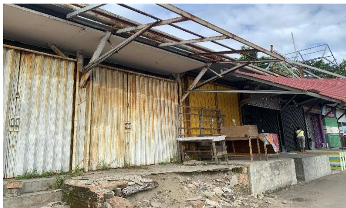
Gambar 1. 2 Kerusakan pada Lapau Panjang Cimpago
