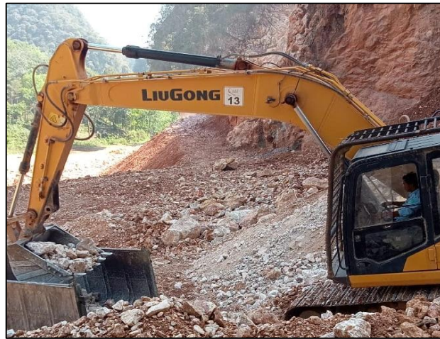
Gambar 1. Pekerja Tidak Menggunakan APD
