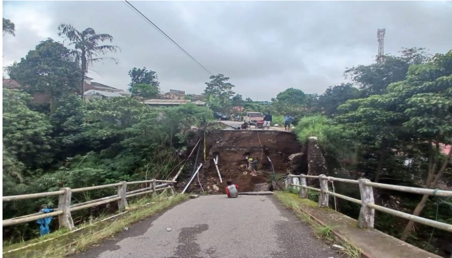
Gambar 1.4 Jembatan Taweh Pasca Bencana Sumber: Dokumentasi PERUMDAM Tirta Serambi
