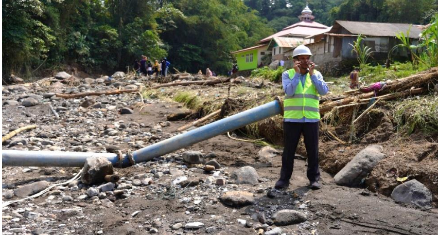
Gambar 1.3 Kondisi Jaringan Pipa Transmisi Gravitasi SPAM Lubuk Mata Kucing
