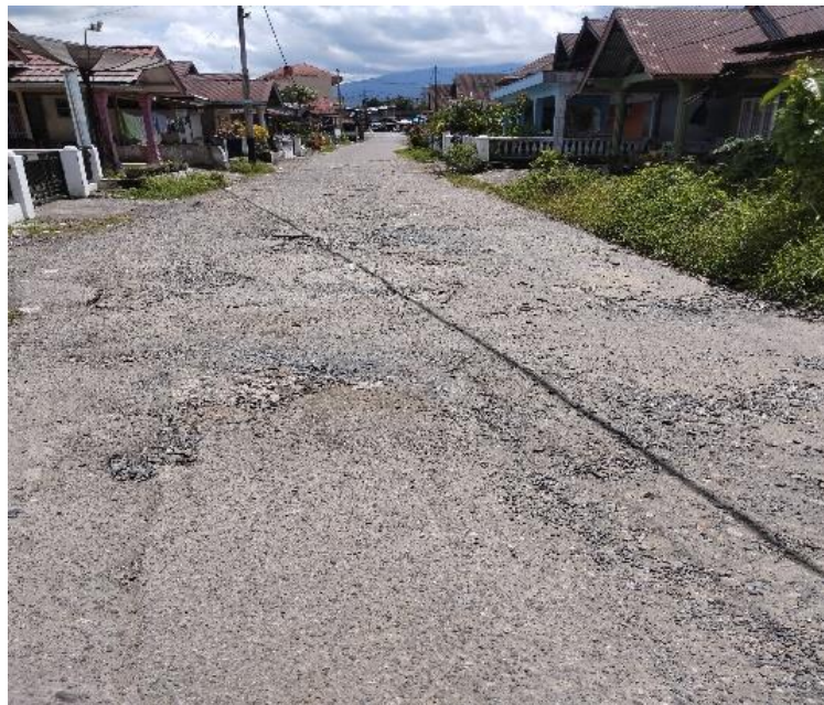
Gambar 1.4 Kerusakan Jalan Akibat Mobil Truk Pengangkut Batu. Sumber : Dokumentasi Peneliti, 2025.
