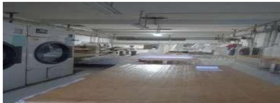
Gambar 3.7 Laundry Area Sumber: Dokumentasi pribadi
