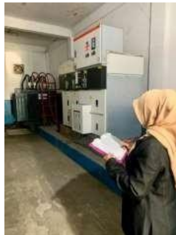
Pencatatan Suhu Trafo
