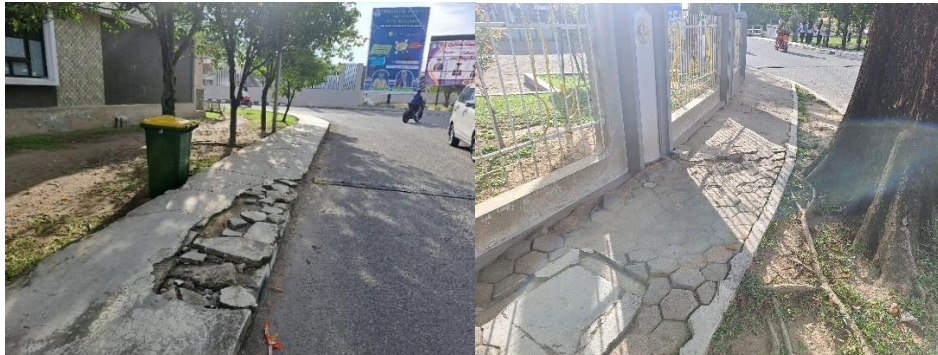
Gambar 4. Jalur Pejalan kaki yang Rusak (Sumber: Dokumentasi Pribadi, 17 Desember 2024)
