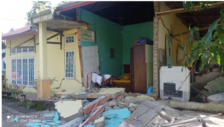
Gambar 1. Dinding Merah Rusak Berat Akibat Gempa Pasaman Barat 2022 (Sumber : Liputan6.com/ Nova Harlina)
