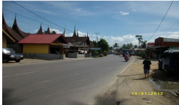
Gambar V.14. Kondisi jalan raya Km. 11 tanpa adanya Median dan Marka Jalan yang jelas diambil tanggal 19/01/2012
