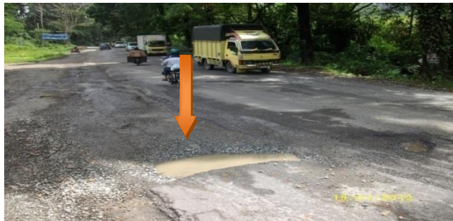
Gambar V.8 Kondisi jalan yang berlubang pada Jalan Raya Padang – Solok Km.22 diambil tanggal 19/01/2012
