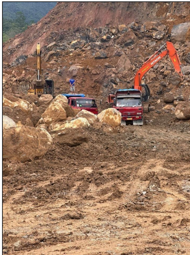
Gambar 1. Tidak adanya pemakaian Alat Pelindung Diri
