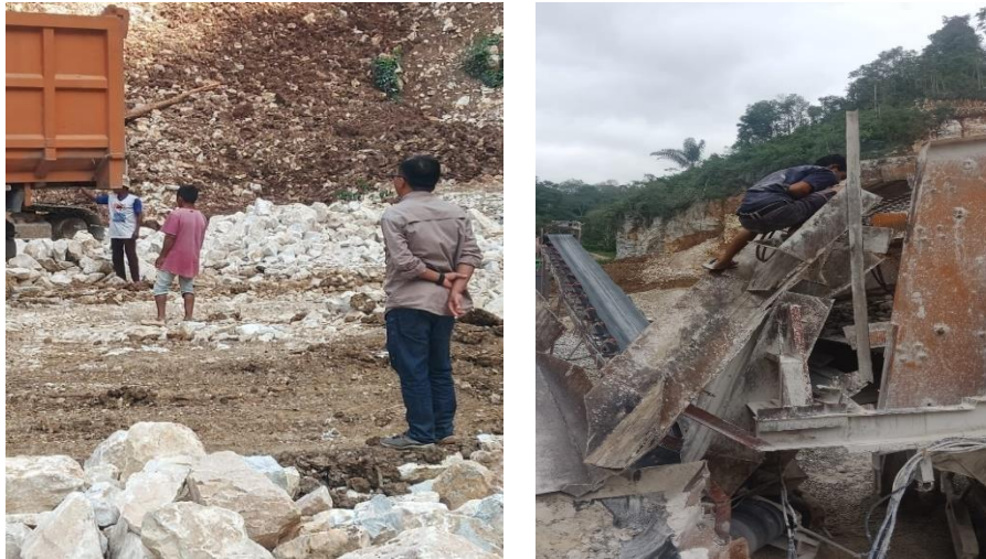
Gambar 1. Para pekerja yang tidak menggunakan safety lengkap
