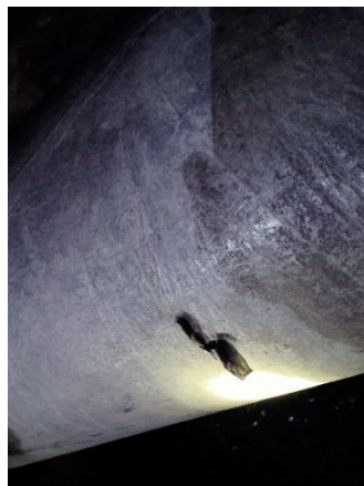
Gambar 2. Kebocoran Pada Duct
