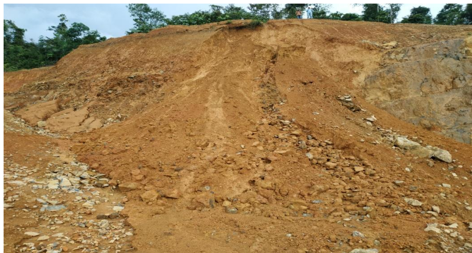
Gambar 2. Longsoran pada lereng jalan pada zona 4.
