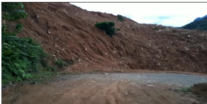
Gambar 1. Kondisi lereng jalan pada zona 4
