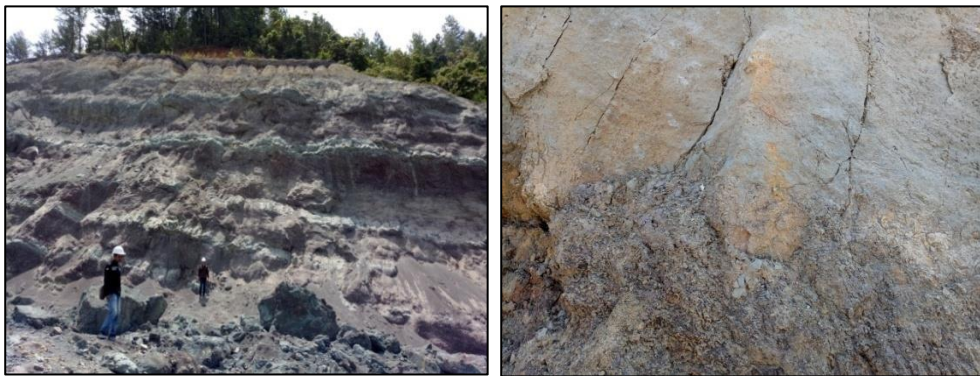
Gambar 1. Kondisi lereng dan bidang lemah pada lereng penelitian
