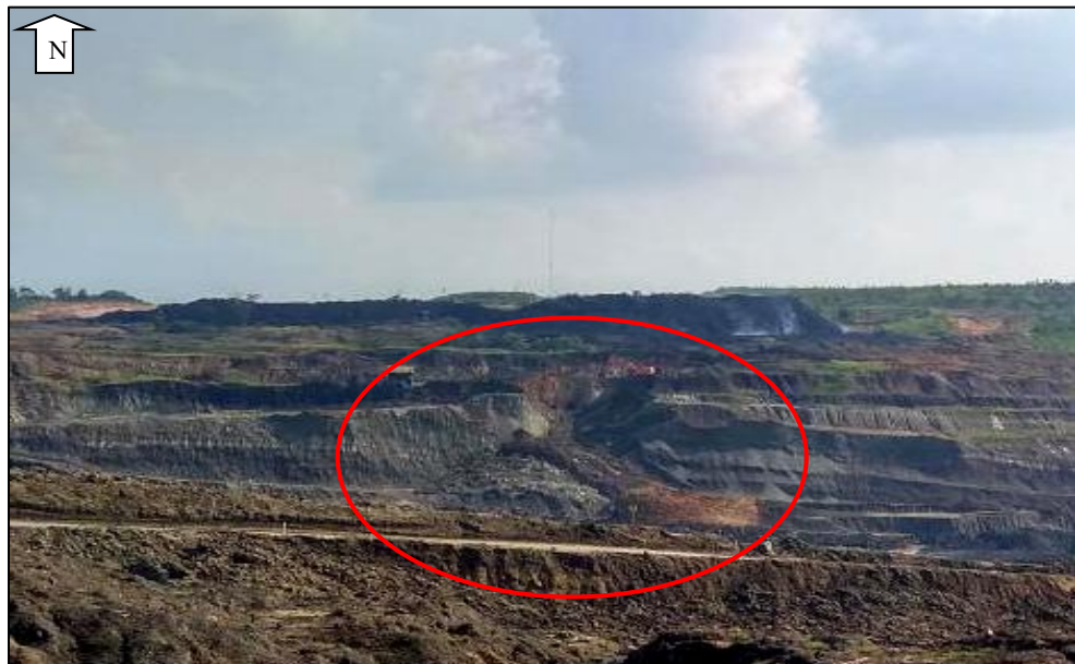
Gambar 1. Longsoran pada Highwall Pit ABC
