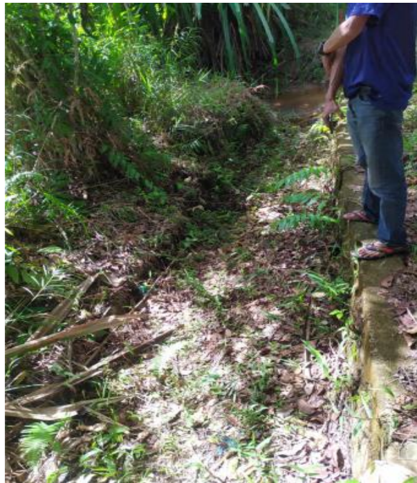
Gambar 12. Saluran Kapalo Hilalang yang mengalami kerusakan.
