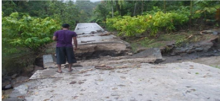
Gambar 22. Jembatan yang putus dekat perkebunan (dokumentasi Penelitian februari 2015)
