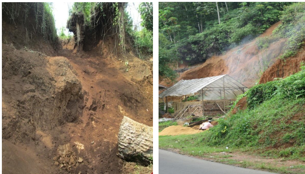
Gambar 17. Pemotongan tebing lereng yang dilakukan secara sembarangan Sumber: Dokumentasi penelitian 2014
