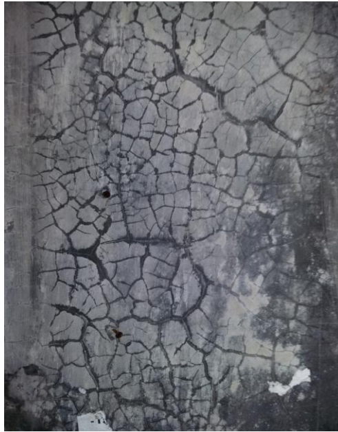
Gambar 5. Tembok Retak. Foto. Bangkit Sanjaya. 2016.
