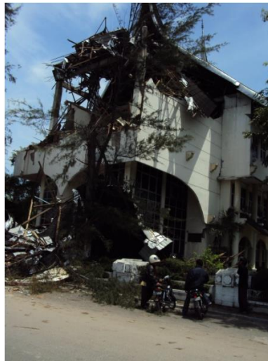
Gambar 2. Kerusakan Bangunan Pasca Gempa 2009 Sumber: INFO UNP, 2019
