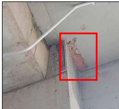
Gambar 1. Spalling Sumber : Dokumentasi Pribadi
