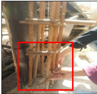
Gambar 2. Terlepasnya Baja Beton Sumber: Dokumentasi Pribadi
