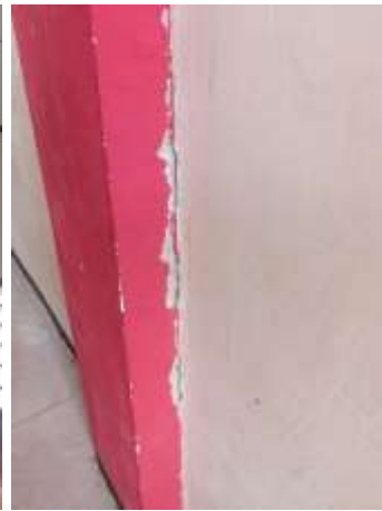
(b) Kerusakan sedang pada dinding ruangan lantai 1
