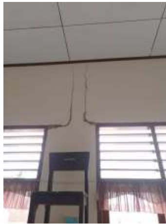
(a) Kerusakan sedang pada dinding ruangan lantai 2
