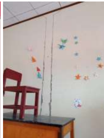
(d) Kerusakan berat antara dinding dan kolom ruangan lantai 2
