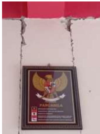
(c) Kerusakan sedang antara dinding dan kolom ruangan lantai 1
