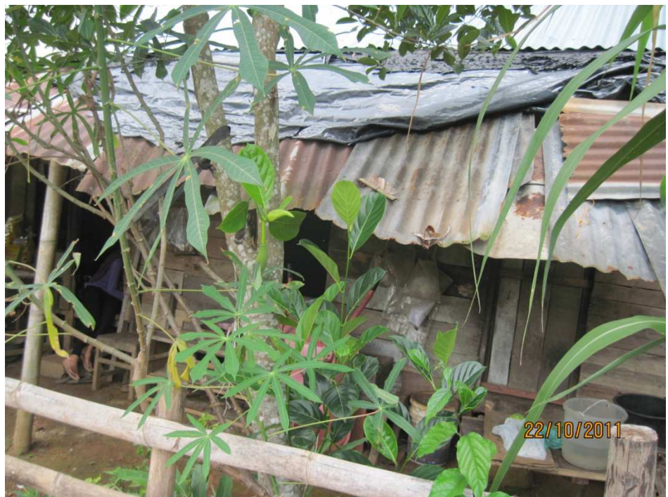
Gambar 32 . Kondisi Atap Rumah Keluarga Tani
