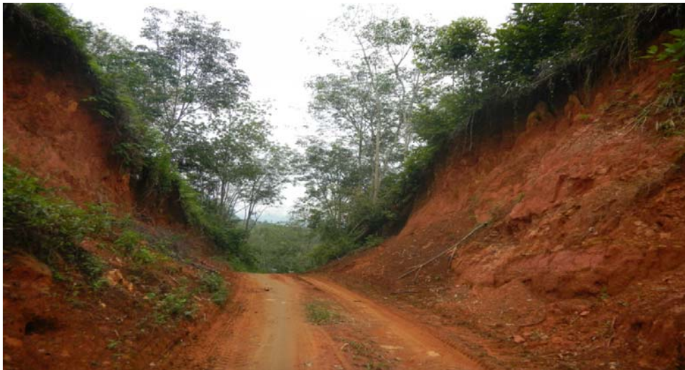
Gambar 18: Pembukaan akses jalan dengan cara melakukan penebangan kayu pada hutan lindung di lokasi Tambang Biji besi PT. Royalti mineral bumi di Kenagarian Pulakek, Kecamatan Pauh Duo, Kabupaten Solok Selatan (tanggal 14 maret 2013)
