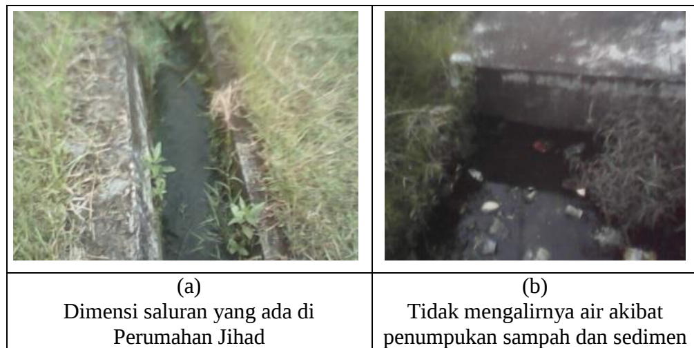
Gambar 1.2 (a) dan (b) Saluran drainase di Perumahan Jihad Indah Persada 2 Sumber: Dokumentasi 2012
