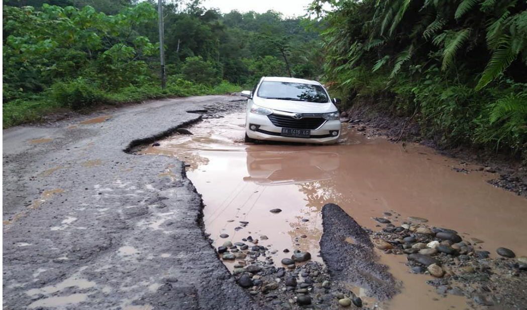
Gambar 1.1 Kerusakan jalan akibat sering dilalui kendaraan yang bernomor Polisi Luar Daerah
