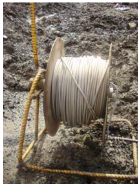
Gambar 17 : Kabel utama untuk peledakan
