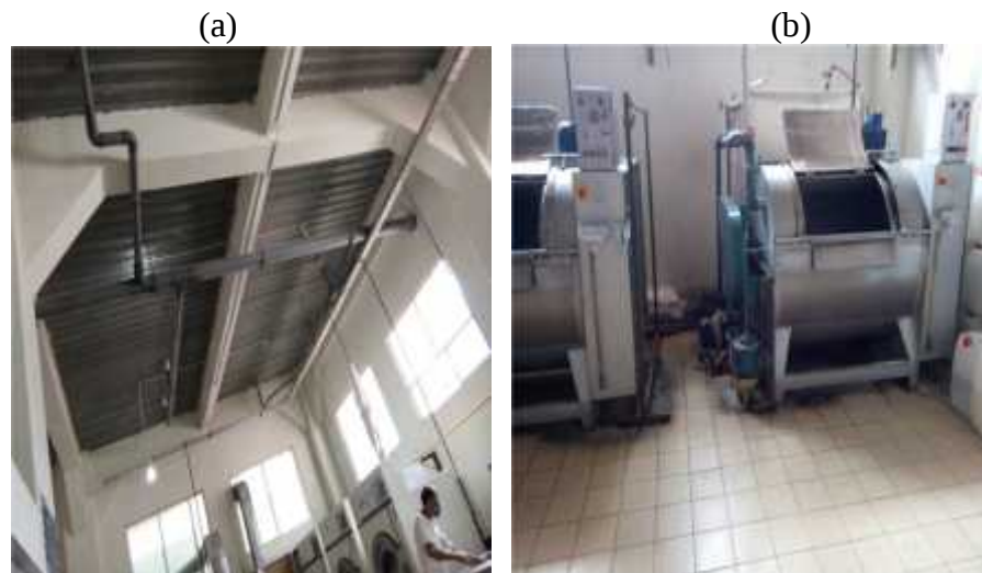
Gambar 3 (a) Ruang kerja yang tidak bersih dan panas, seperti adanya jaring laba-laba di atap ruang kerja laundry . (b) Ruang kerja yang tidak bersih seperti adanya lumut di lantai laundry dan kain yang berserakan.
