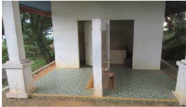
Gambar 1. Toilet umum di objek wisata Gunung Padang yang tidak terawat.
