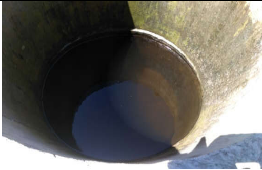
Gambar 16. Kondisi Air Sumur di ULU 3
