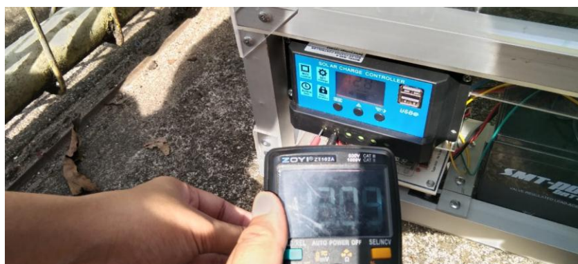
Gambar 34. Tegangan masuk pada Panel Surya
