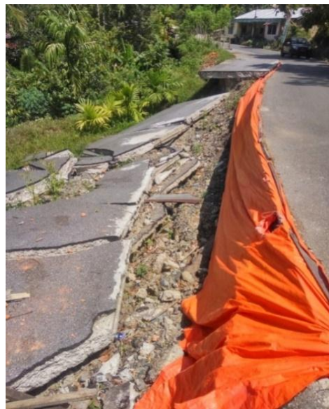
Gambar 2. Jalan Longsor di Desa Saringan Sumber: Dokumen Lapangan
