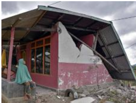
Gambar 1. Bentuk kerusakan pada bangunan akibat gempa
