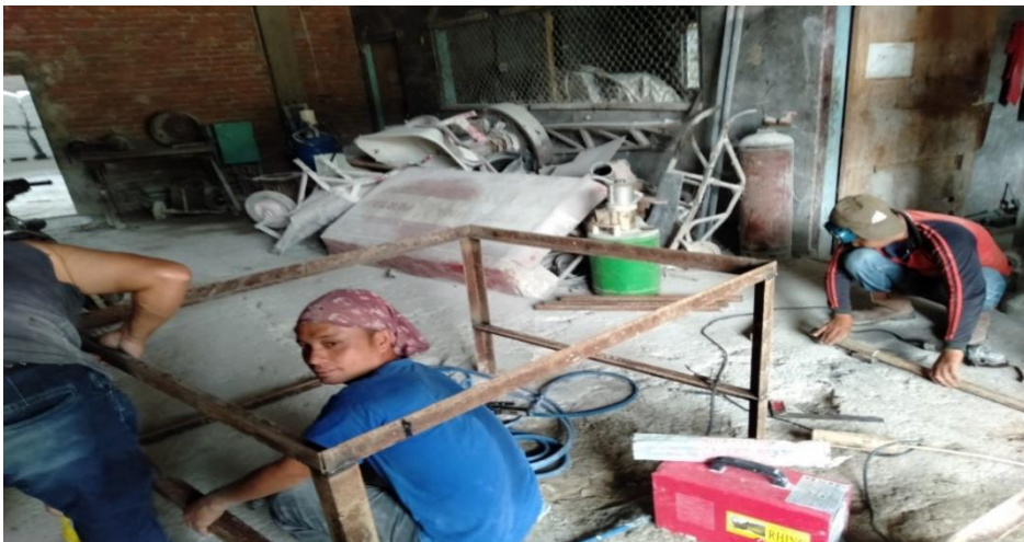
Gambar 9. Karyawan yang Tidak Menggunakan APD
