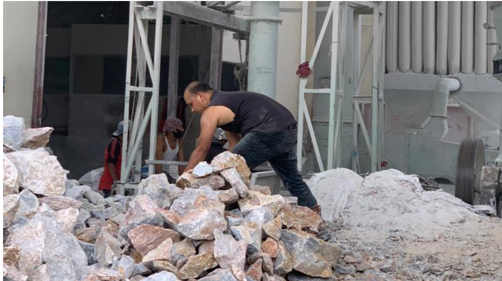
Gambar 10. Karyawan yang Tidak Menggunakan APD
