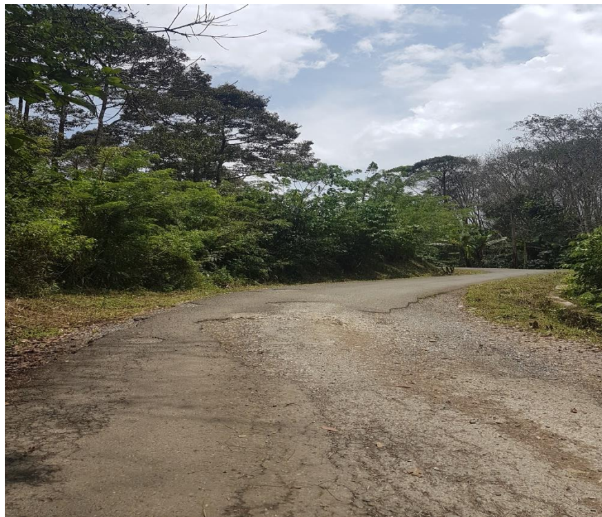
Gambar 2: Akses jalan dalam keadaan rusak dan berlubang Sumber: Dokumentasi Penulis (2020)
