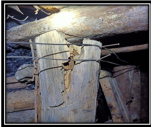
Gambar 20. Tiang yang rusak
