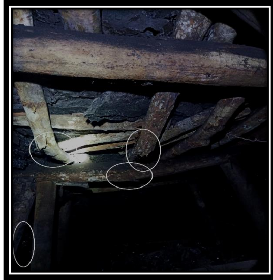
Gambar 24. Kerusakan beberapa titik penyangga
