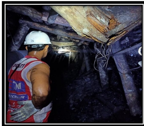
Gambar 23. Kerusakan tiang, cap, stafling dan pagaran
