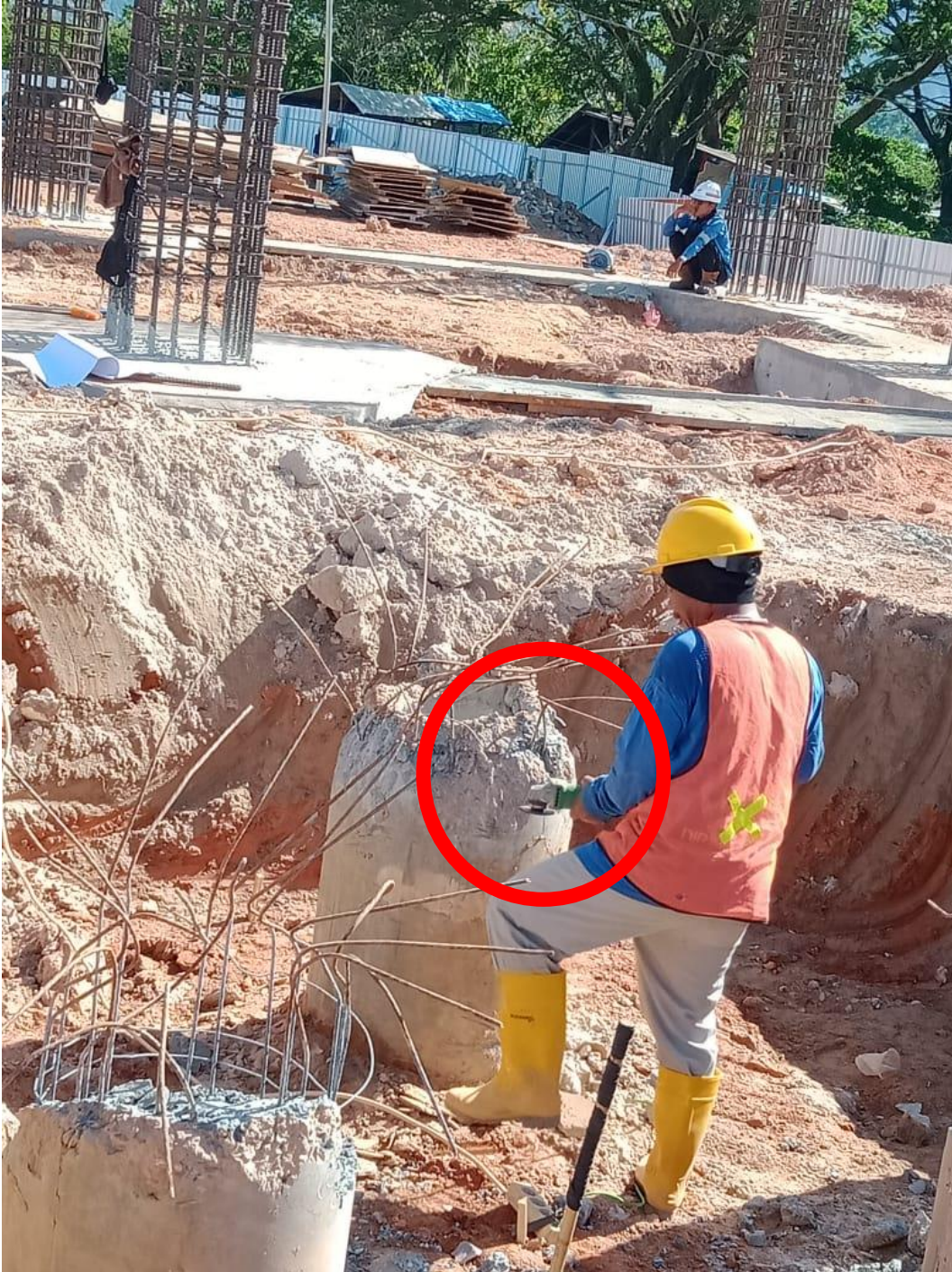
Gerinda tangan pekerja tidak memiliki cover
