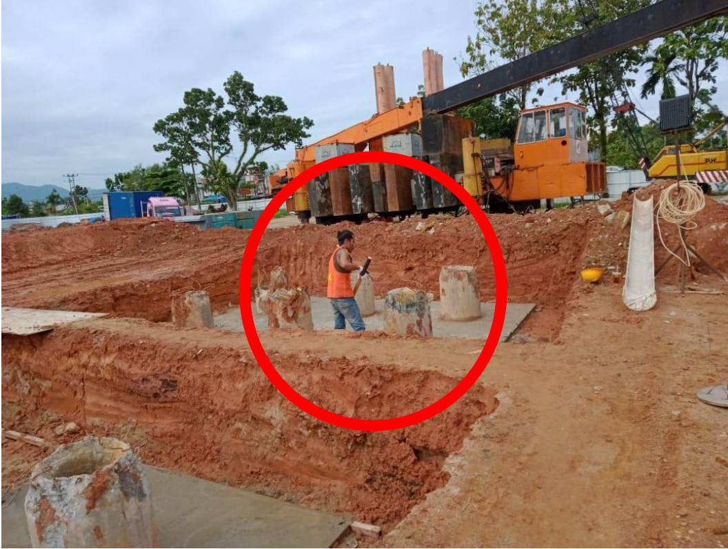
Pekerja yang tidak menggunakan APD
