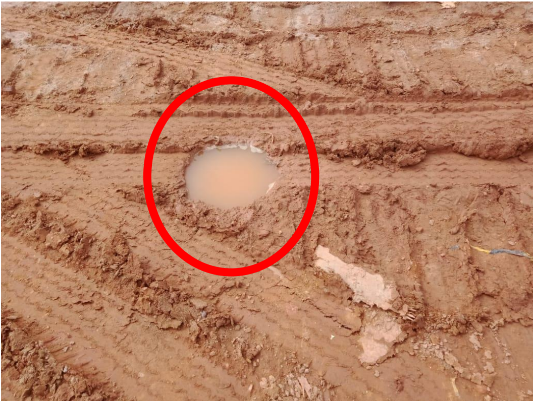
Lubang tiang pancang yang tidak diberi safety sign ataupun penutup
