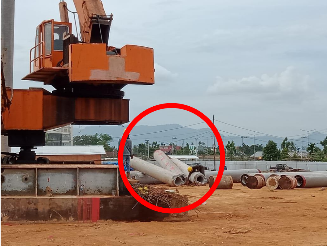
Material sisa tiang pancang yang tidak disusun rapi dapat menimpa pekerja
