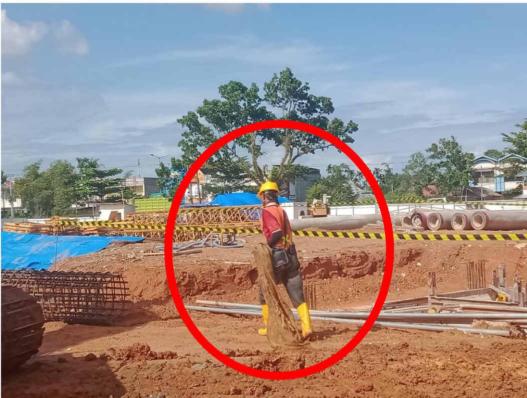
Webbing sling yang sudah rusak masih digunakan
