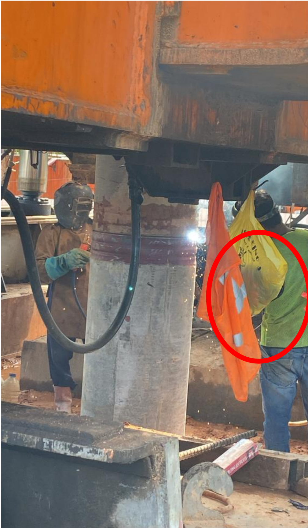
Pekerja las tidak menggunakan apron
