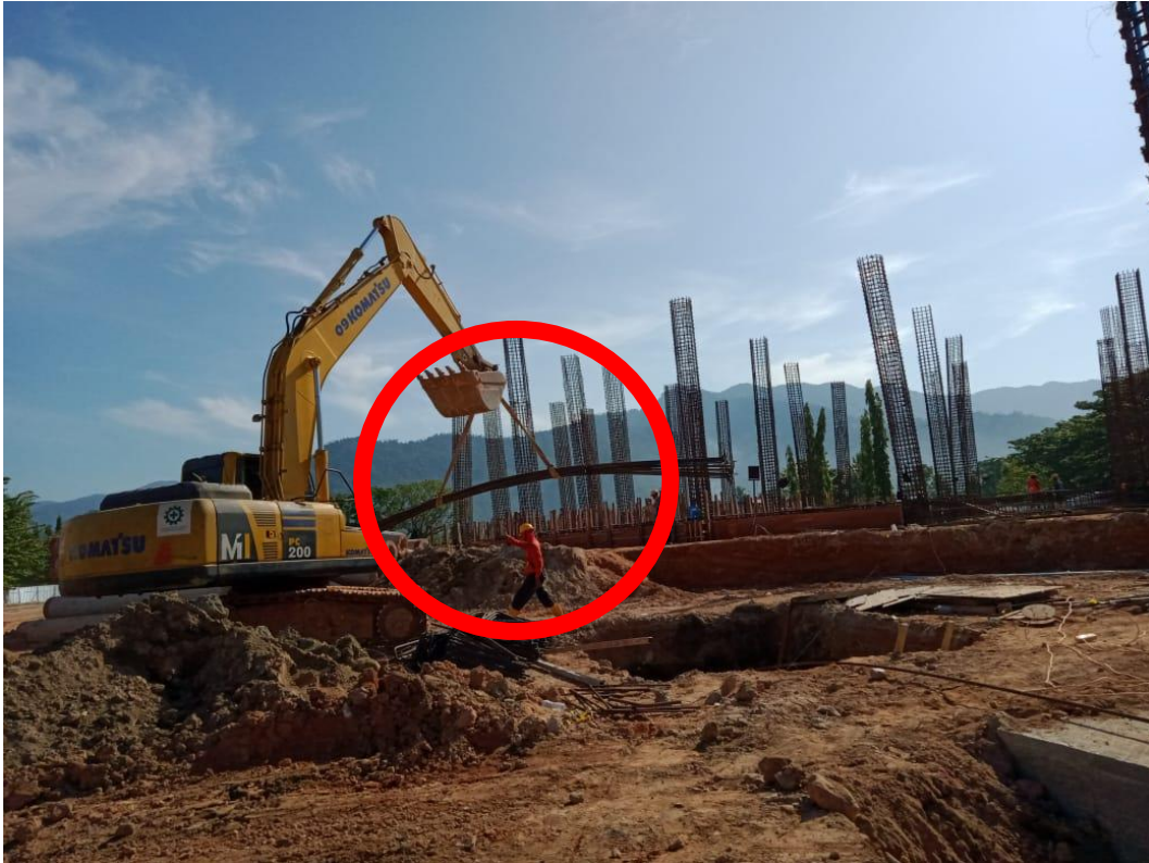
Pekerja berada dibawah material yang sedang diangkat
