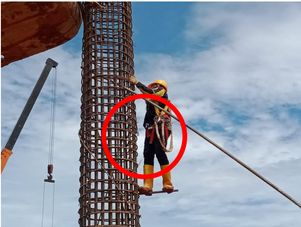
Pekerja tidak menggunakan Full Body Harness dengan baik
