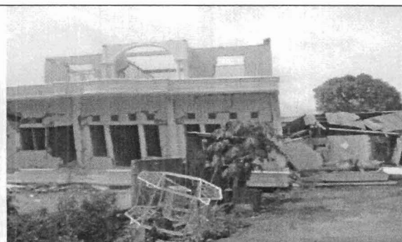
Rumah penduduk jalan ampang kec Kuranji
