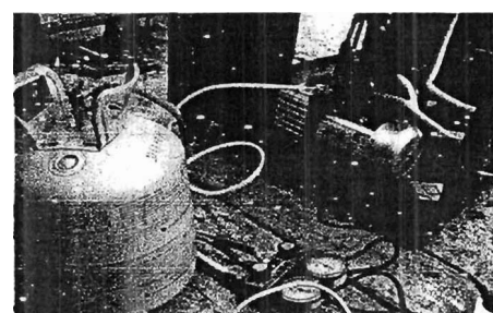
Gambar 23. Pompa vakum dan tabung freon
