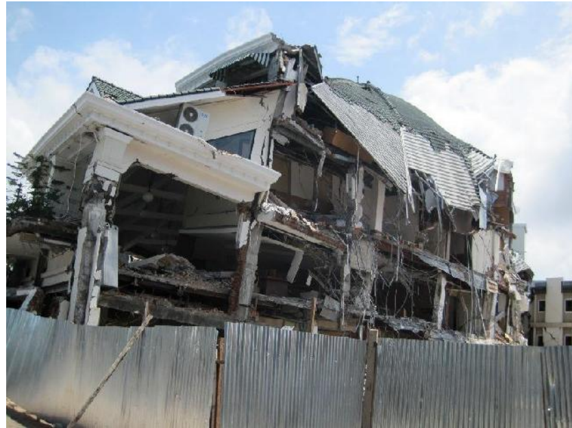
Gambar 1. Kerusakan Hotel Ambacang Sumber: Wikipedia.org
