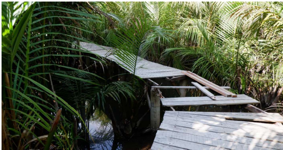
Gambar 1.1. Kerusakan fasilitas track lintasan wisatawan kedalam hutan talao
