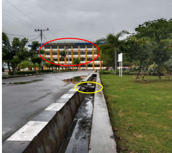
Gambar 3. Gedung Baru dan Rusaknya Drainase
