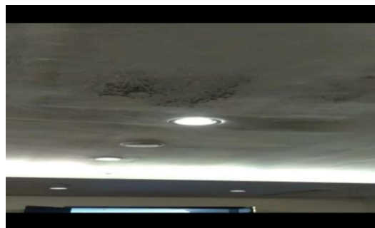
Gambar 5 Plafon Berjamur dan Rusak
